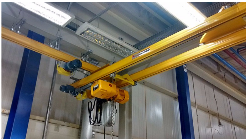
Figura 3 – Ponte rolante biviga suspensa.
