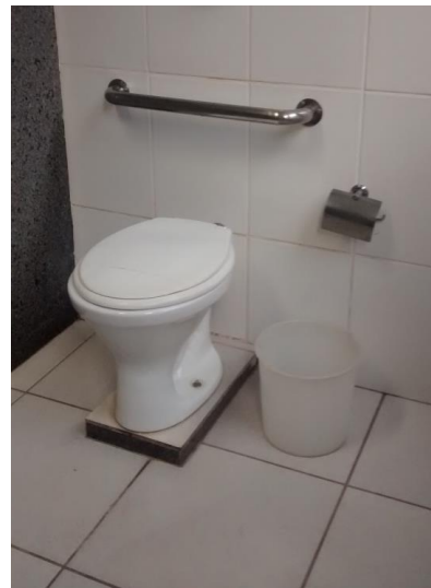
Instalações sanitárias adaptadas
