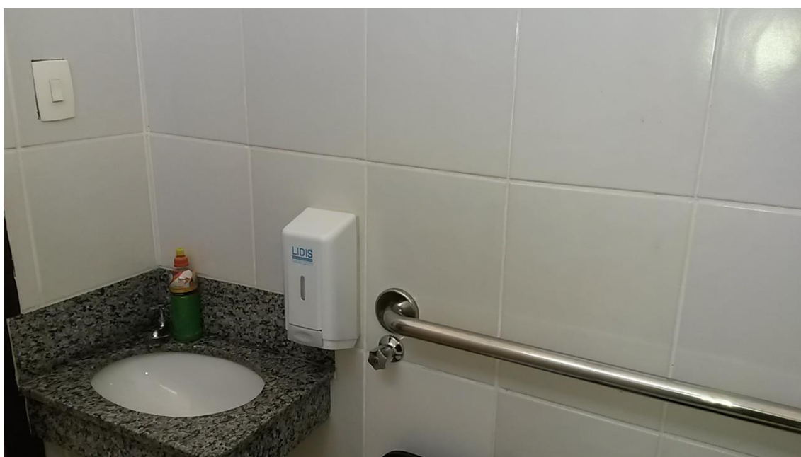
Figura 20 - Detalhe do banheiro para P.N.E. - Barras de apoio instaladas.
