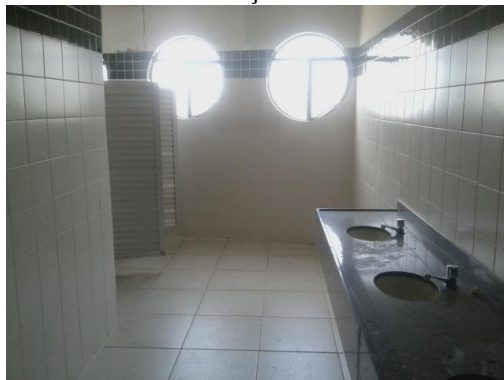
Figura 52 - Vista interna Instalações Sanitárias do Bloco Didático
