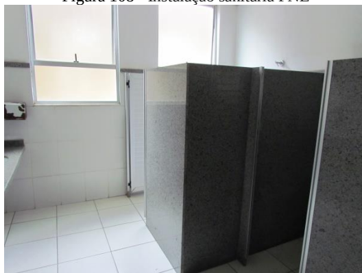
Figura 108 - Instalação sanitária PNE
