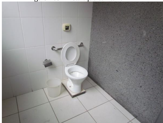
Figura 109 - Instalação sanitária PNE
