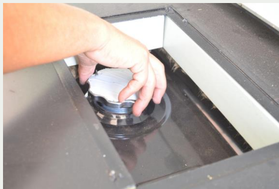
Figura 45: Tampa para abastecimento do gerador
