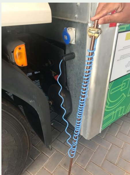
Figura 43: Haste de aterramento.
