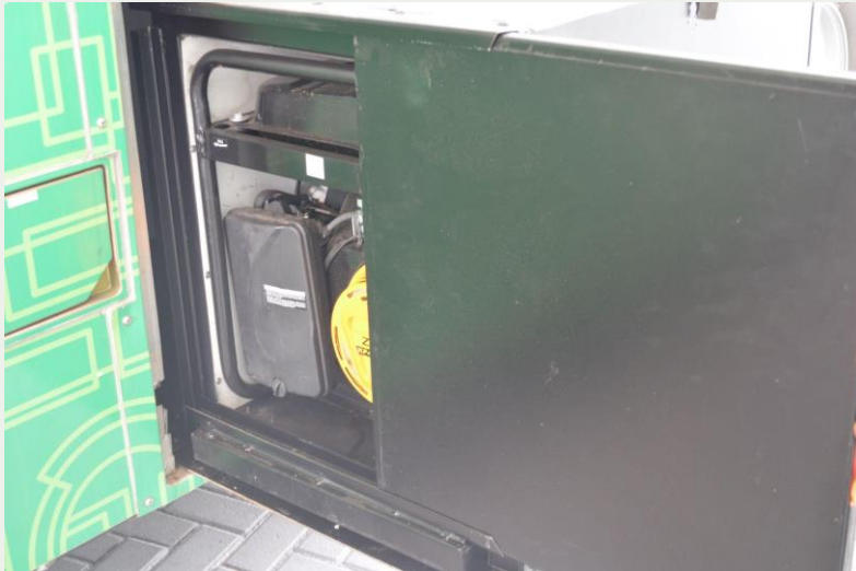
Figura 50: Tampa de proteção do gerador
