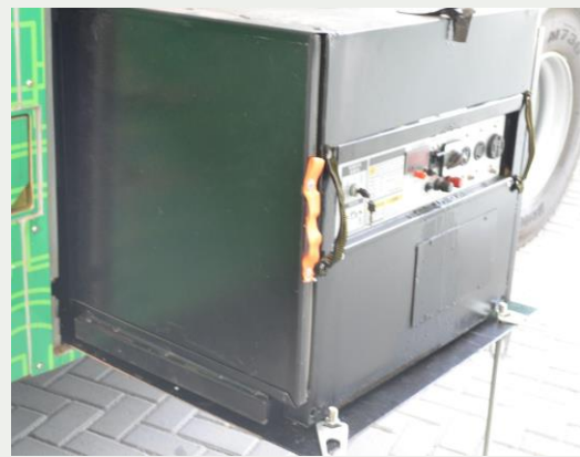
Figura 48b: Gerador instalado sobre a base
