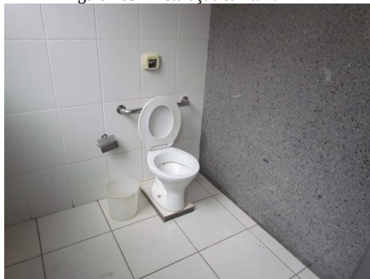
Figura 109 - Instalação sanitária PNE
